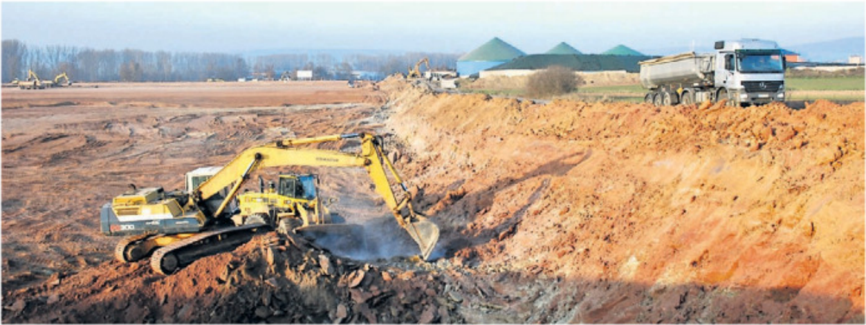
Bis zu zehn Meter tief wird der Geländeeinschnitt für das Logistikzentrum. 200 000 Kubikmeter Erde werden bewegt. Foto: Schulten
